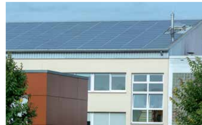
Caritas-Haus/Nachbarschaftszentrum mit der neu installierten Photovoltaikanlage
